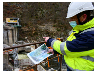
Le nouveau Poutès sera équipé de deux vannes centrales qui seront ouvertes trois mois dans l'année afin de permettre au saumon de ne pas rencontrer d'obstacle sur son parcours. Photo Le Progrès /Christophe BOUYER
